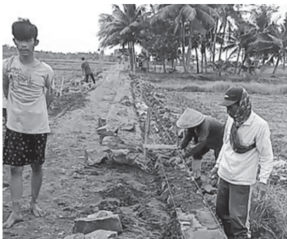
Pembangunan Jalan Usaha Tani (JUT) di Desa Cimrutu Kecamatan Patimuan Kabupaten Cilacap (Asep Sujana)
