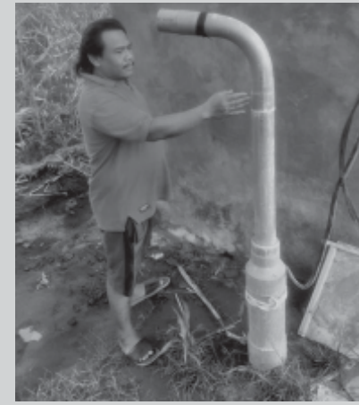
Bayu menunjukkan pipa paralon yang di gunakan untuk saluran air (dari sumur) di duga tidak sesuai spek.
