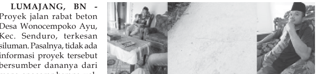
Kasun Sarwo Edi dan jalan Rabat Beton Dusun Purut nampak sudah retak-retak serta Kades Sutiyono.
