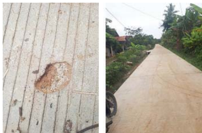
Tampak rabat beton sudah berlubang. (ari)
