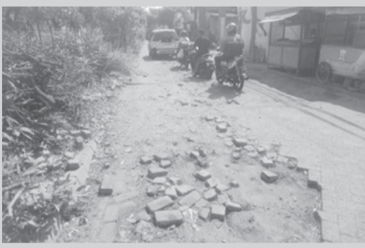
Kondisi infrastruktur jalan rusak di Desa Bohar, Kecamatan Taman, Kabupaten Sidoarjo di depan warung kopi yang berdiri di atas Tanah Kas Desa (TKD) Bohar (yah)
